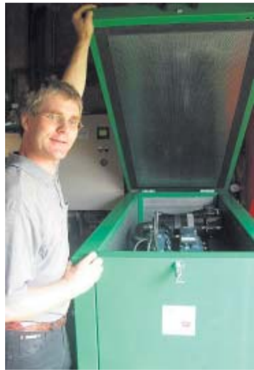
Ulrich Steinmeyer am Blockheizkraftwerk, das mit Rapsöl läuft. FOTO: JOHANNES HEEG
